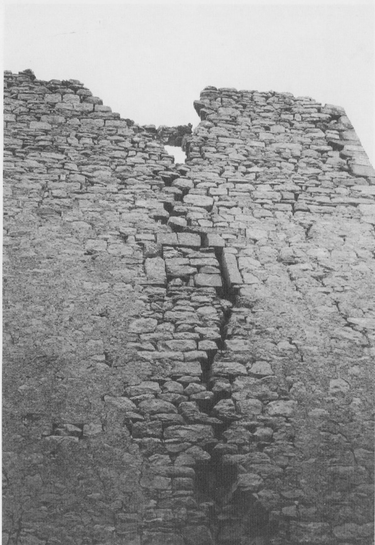
Torre di Montalceto, retro - è evidente l'ampia frattura estesa per tutta la parete. Si nota anche la finestra tamponata e alla sinistra di chi guarda tracce evidenti di intonaco
